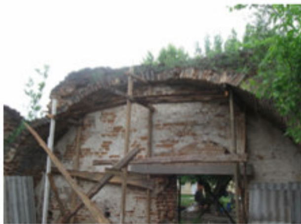
Рисунок 5 – Залишки перекриття 1-го поверху будинку ігумена
